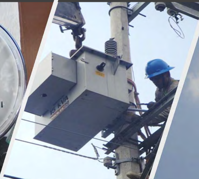
MVA DE TRANSFORMACIÓN
