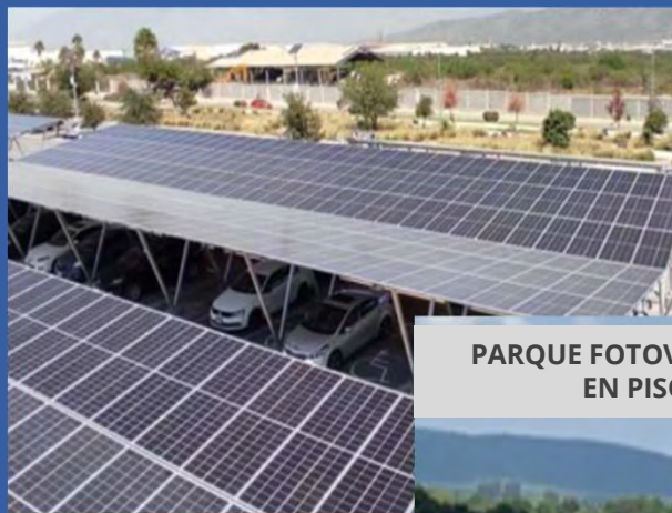
PARQUE FOTOVOLTAICO EN CARPOT
